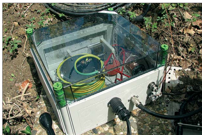
Bild 1: Anpassbox am Antennenfußpunkt; links führen die beiden Steuerkabel ins Gehäuse, daneben ist eine PL-Buchse samt Koaxialkabel angebracht. Rechts befinden sich Edelstahlsschrauben zum Anschluss des Strahlers und des Masseanschlusses. Letzterer ist mit einer Edelstahlplatte verbunden, an der die Gegengewichte befestigt sind.
